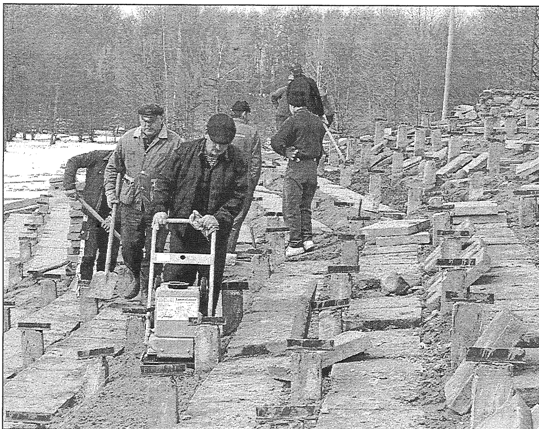
● 3. Trisvaigžņu spēļu atklāšanas un noslēguma ceremonijai skatītāji varēs sekot svairgi remontētajā Preiļu parka estrādē. Šeit būs jauni soli, bet vispirms starp tiem tiek mainīts plākšņu segums. Lai plākšnes neizšķobītos un nedrupu, zem tām tiek nobērtas un noblētā smilšu kārtas. Foto: M. Rukosujevs
